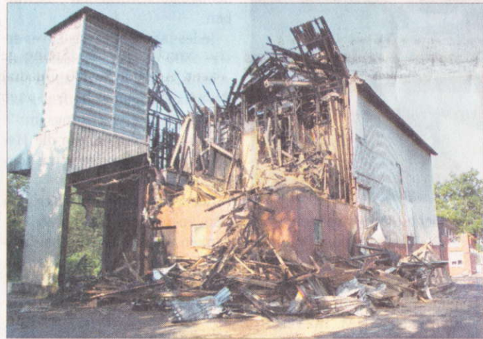
Hoher Schaden: Die Futtermittelmühle war gestern einsturzgefährdet. Der hintere Teil blieb nahezu unversehrt. Foto: Kläne
